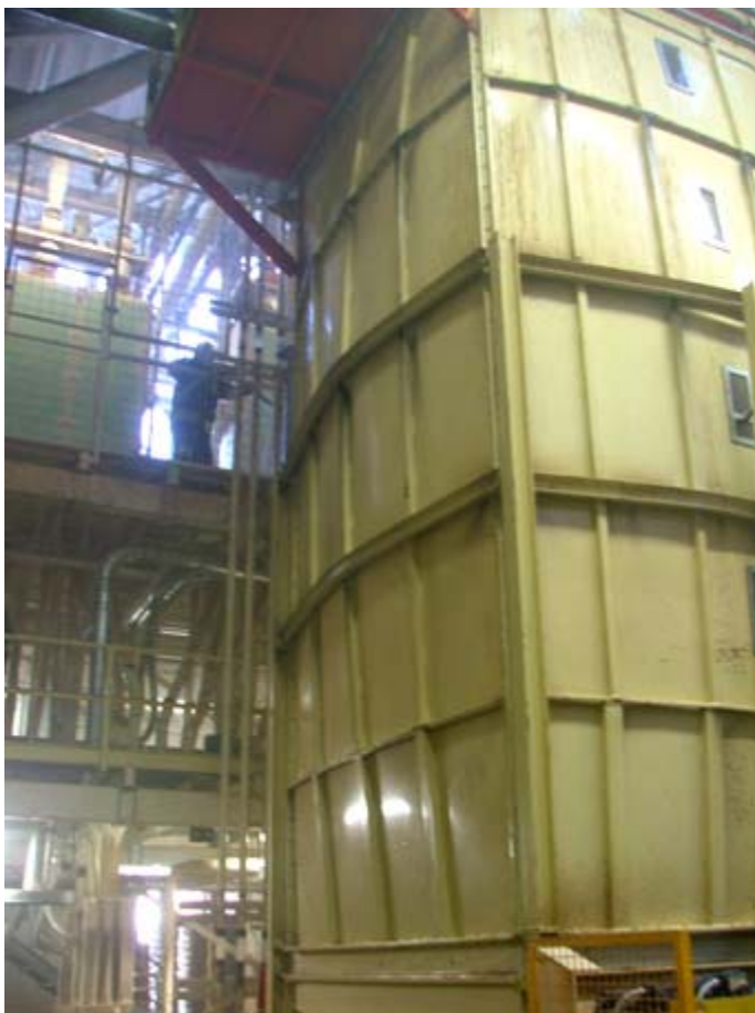
Foto n. 2 - Deformazione silos contenente polveri di legno a seguito di propagazione di onda esplosiva
